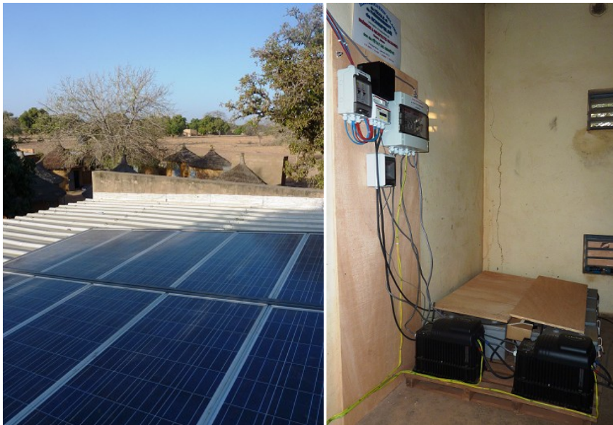
Les panneaux solaires sur le toit de la centrale, au Centre d'hébergement
